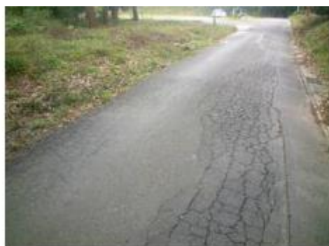
アスファルト舗装の 老朽化
