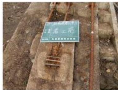
ため池における 老朽化したゲート
