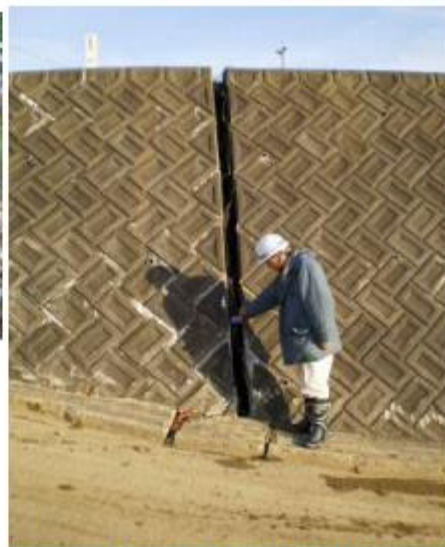
ブロック積みの隙間
