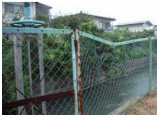
破損した金網フェンス
