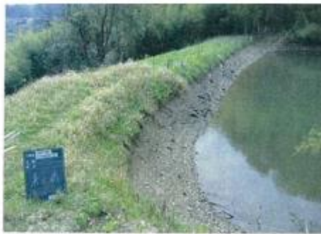
漏水が生じているため池
