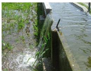
水路からの部分的な溢水
