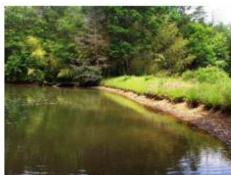
堤体が洗掘されているため池
