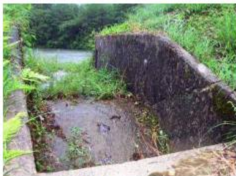
老朽化した洪水吐
