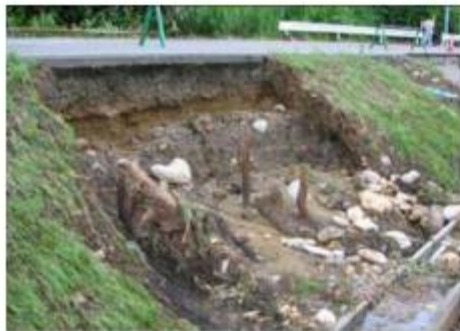
道路法面の崩壊
