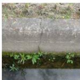
縦方向のひび割れ
