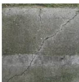
斜め方向のひび割れ
